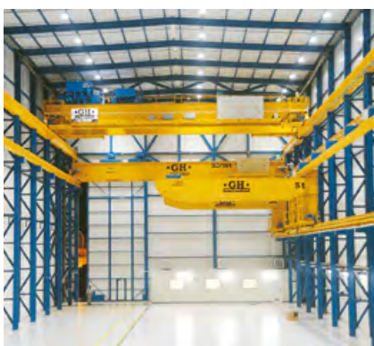
Grúa apoyada birraíl y grúa ménsula
